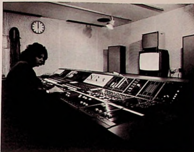
Bild 4. Zentraler Regiebereich für die Säle 1, 2, 3 und 6
